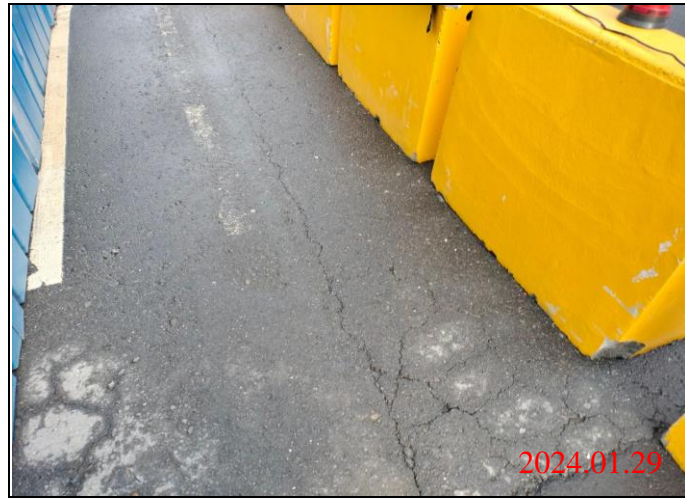
巡查日期地點：113.01.29/ Y23車站 照片說明：路面龜裂狀況
