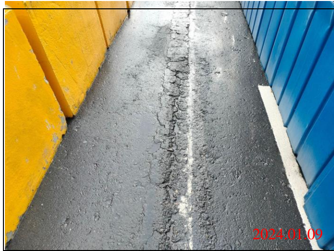
巡查日期地點：113.01.09/ Y23車站 照片說明：路面龜裂狀況
