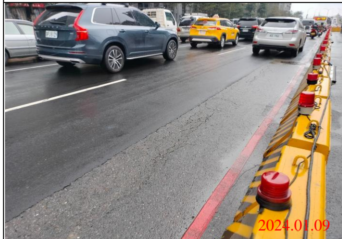
巡查日期地點：113.01.09/ Y23車站 照片說明：路面龜裂狀況
